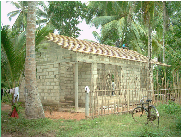
Endlich ein Dach! Jetzt kann die Familie in ihr neues Haus ziehen.
